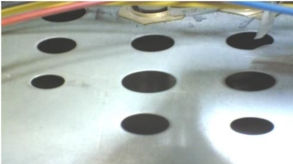
شکل 2-3 سطح کف تابلو
